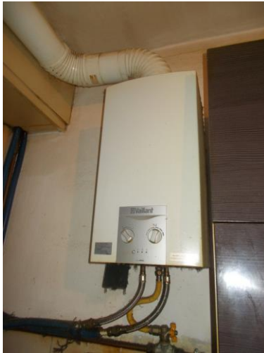
45. Caldaia interna (in cucina)
