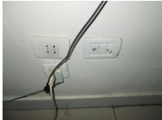
50. Dettaglio componente elettrica
